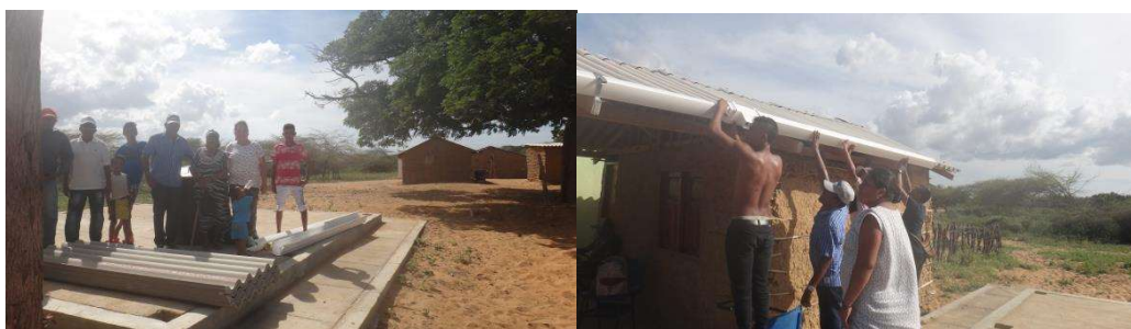
Figura 24. Yanama para instalación de aprovechamiento de aguas lluvias en la comunidad de Amuruluba
